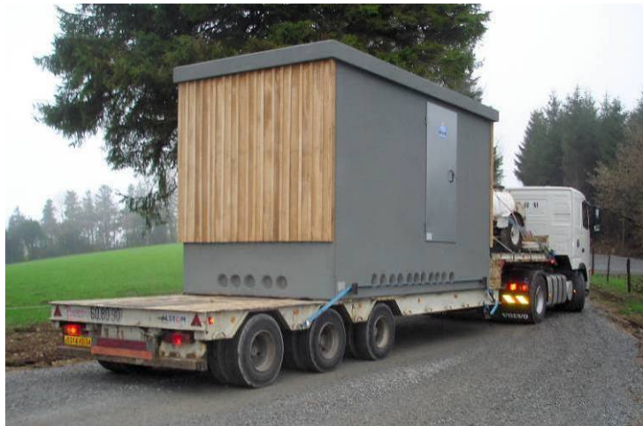
Illustration 7 : Arrivée d'un poste de livraison sur un site éolien
