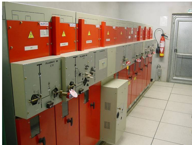
Illustration 6 : Intérieur d'un poste de livraison
