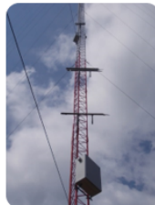
Panneaux photovoltaïques (les 2 au milieu) et boîtiers d'enregistrement (de part et d'autre)
